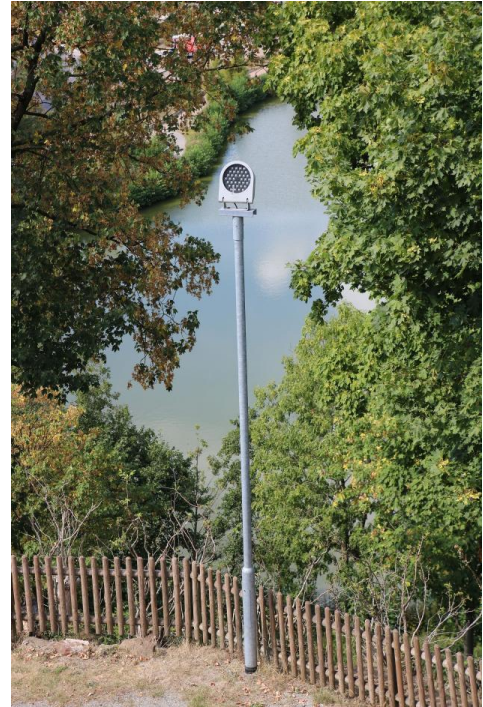
Dank einer Sanierung in 2017 beleuchten jetzt energiesparende LED-Strahler das Schloss.
